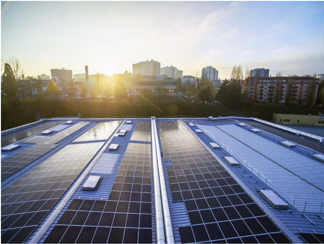
Fig. 5 Panneaux photovoltaïques sur un des bâtiments de blueFACTORY
